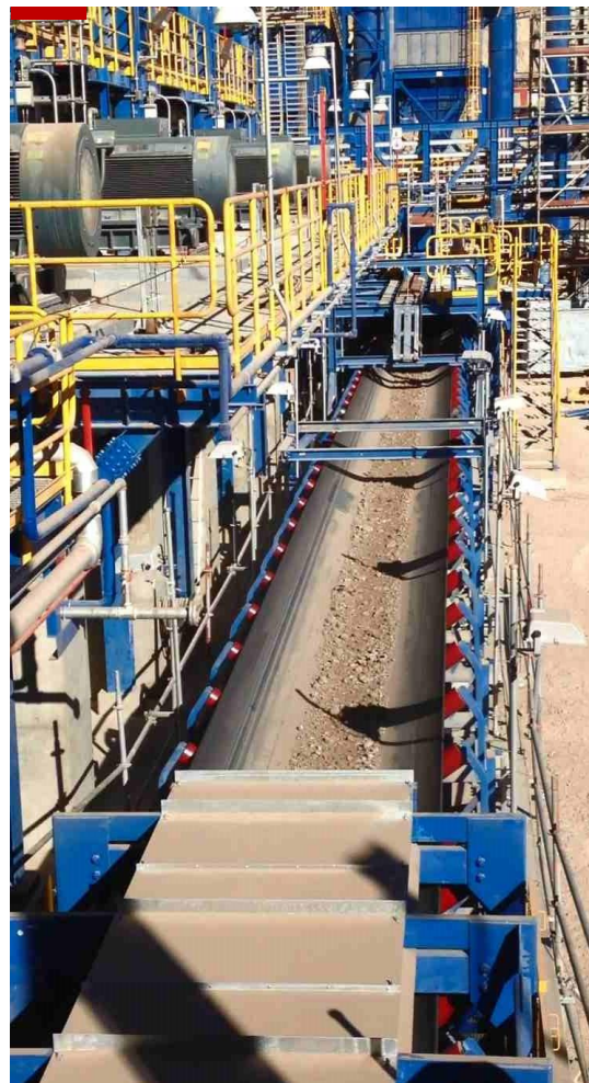
Przenośnik taśmowy CV-160 z pierwszą ostatecznie pokruszoną rudą transportowaną do magazynu ostatecznie pokruszonej rudy
