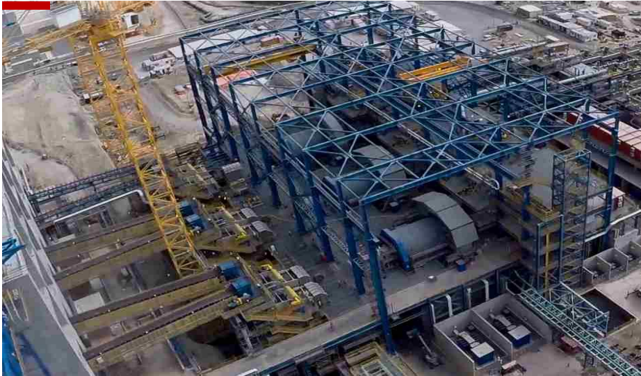
Młyny kulowe (dodatkowo widoczne podajniki taśmowe i przesiewacze III stopnia)
