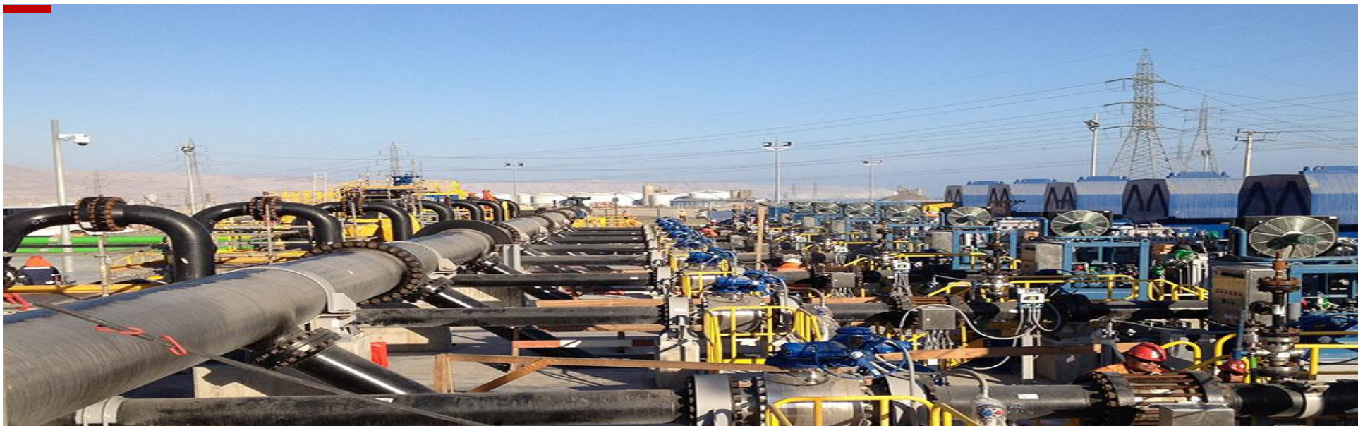
Rurociąg wody morskiej i stacja przepompowa
