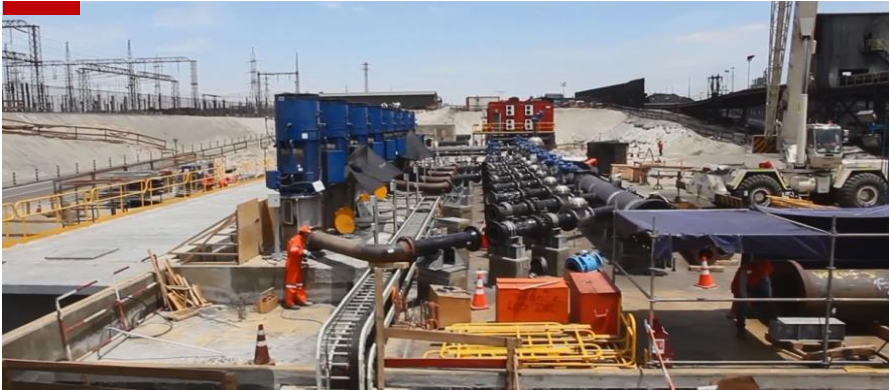
▪ Rurociąg wody morskiej – stacja nadbrzeżna
