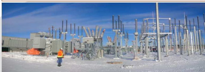
Stacja transformatorowa 230 kV (Victoria)
